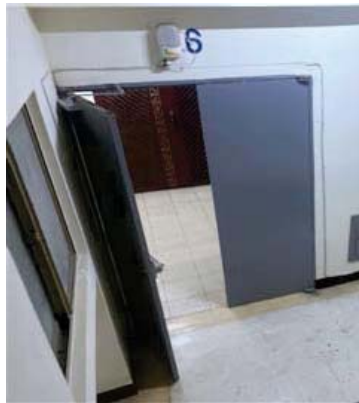
▲ 安全梯防火門無法自動復歸
