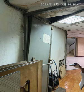
▲走廊通道堆積雜物
