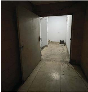
▲防火門無法正常復歸
