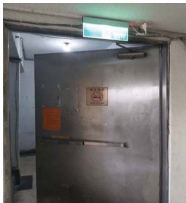
▲防火門無法正常復歸
