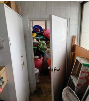
▲ 走廊通道堆積雜物
