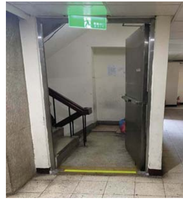
▲防火門無法正常復歸
