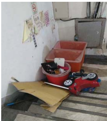
▲樓梯間堆積雜物
