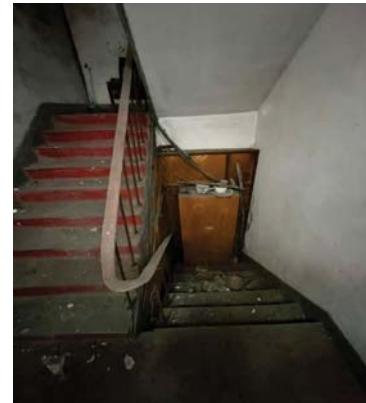
▲ 樓梯堆積雜物
