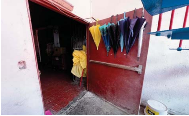
▲ 防火門無法正常復歸
