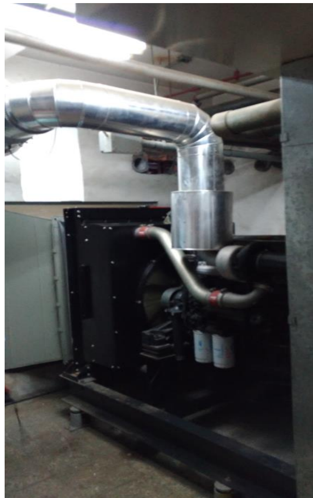
緊急發電機(300KW)
