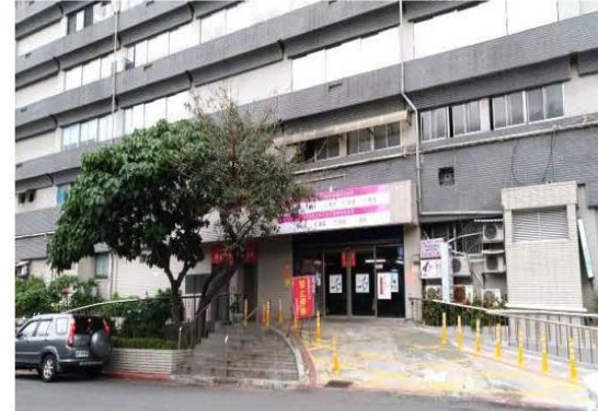
9 磺港路市場出入口高低差
