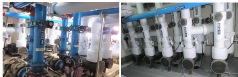
冰水主機、冰水泵、冷卻水塔
