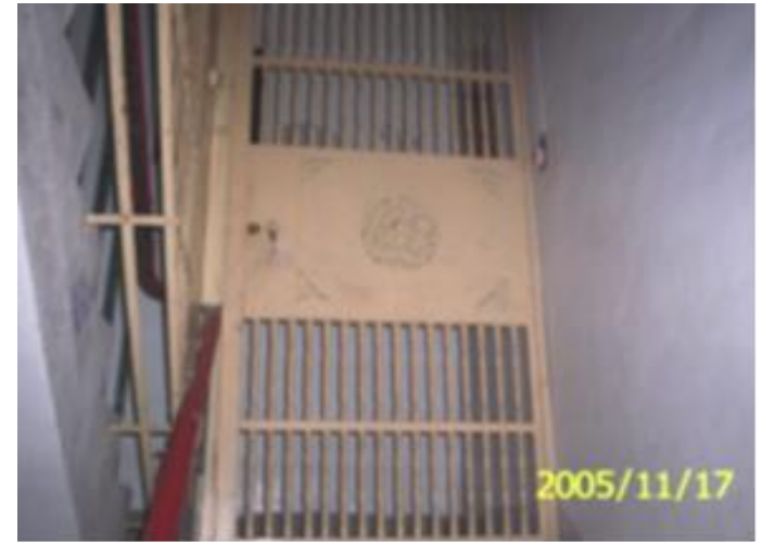
▲ 安全梯間擅自設置柵門違反公寓大廈管理條例第16條規定
