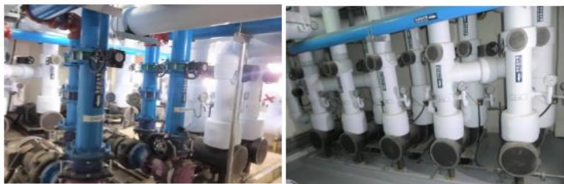
冰水主機、冰水泵、冷卻水塔
