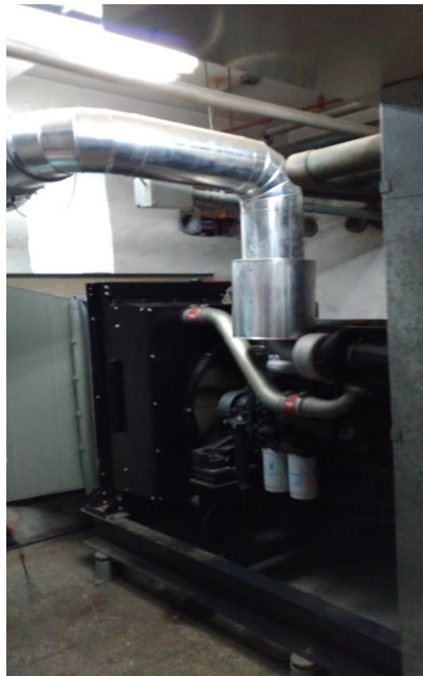
緊急發電機(300KW)
