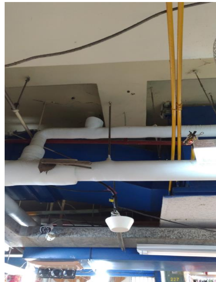
管線佈設壓迫空間淨高
