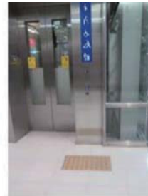
昇降機引導設施設置案例
