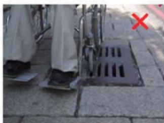
溝蓋開口過大，造成輪椅前輪陷入
