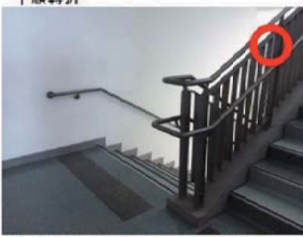
樓梯往上之梯級部分，起始之梯級退至少一階，使扶手平順轉折
