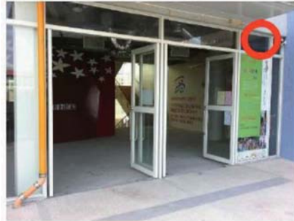
避難層出入口前應設置平台，平台淨寬與出入口同寬，淨深也需大於150公分。
