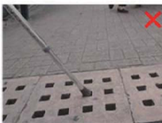
溝蓋開口過大，造成白杖陷入
