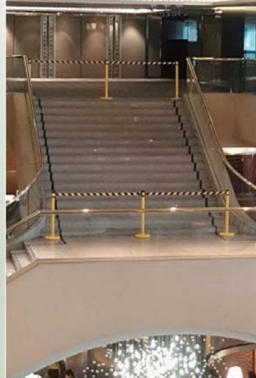
樓梯已設置警示帶預防。(圖由台北市都市發展局提供)
