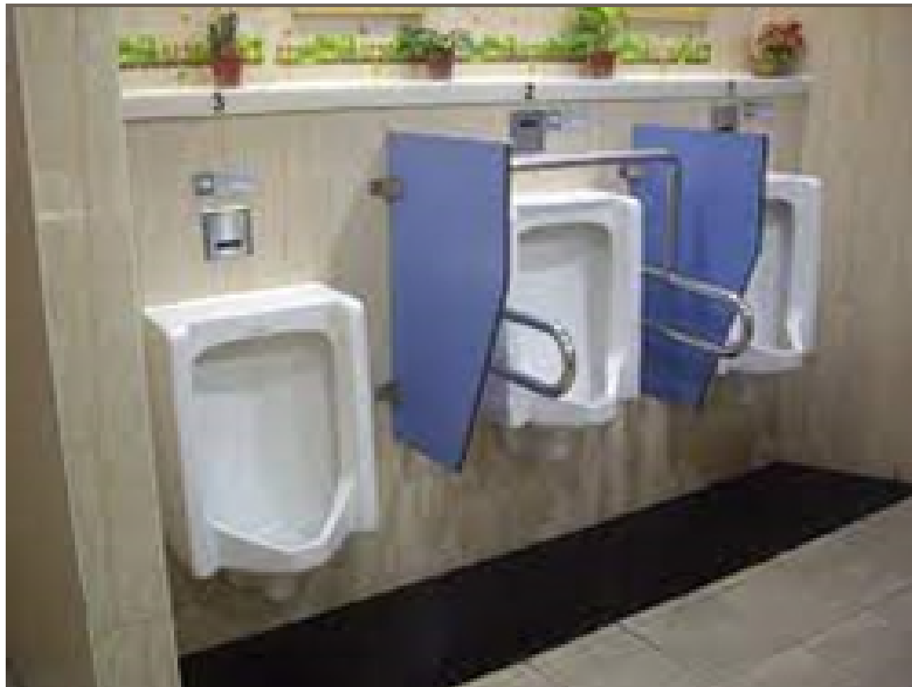
廁所盥洗室-一般廁所無障礙小便器
