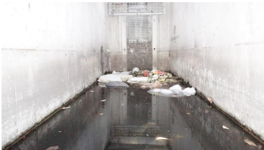
圖II-5-9 出流工之微前池之雜物與出流工攔污柵設施
