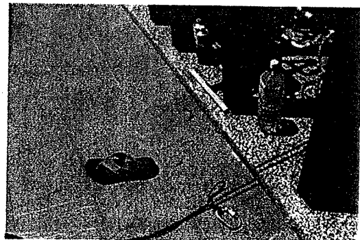
不符規定防墜設備擺放頂樓水塔立管旁地板上
