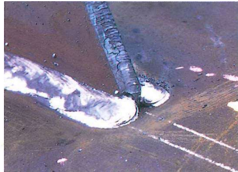
14.端部處理不良
