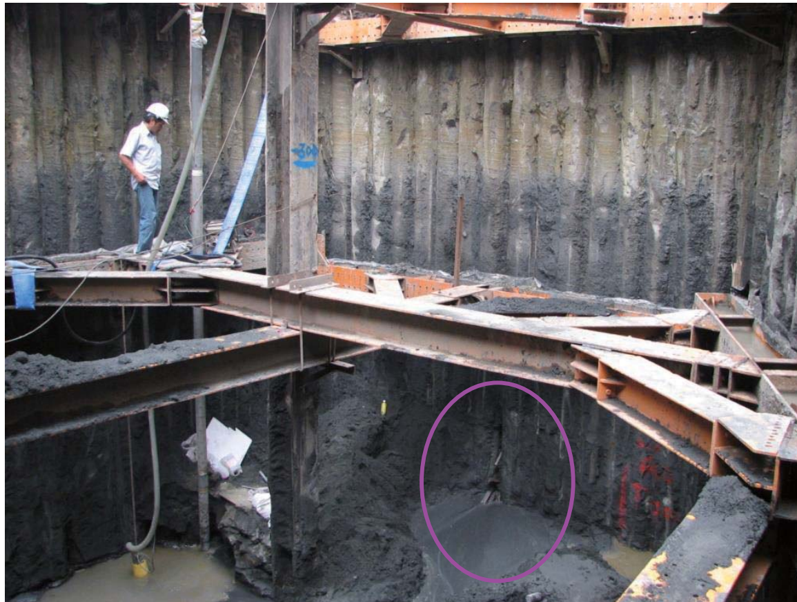
排樁間隙漏水湧砂 (感謝劉泉枝提供)
