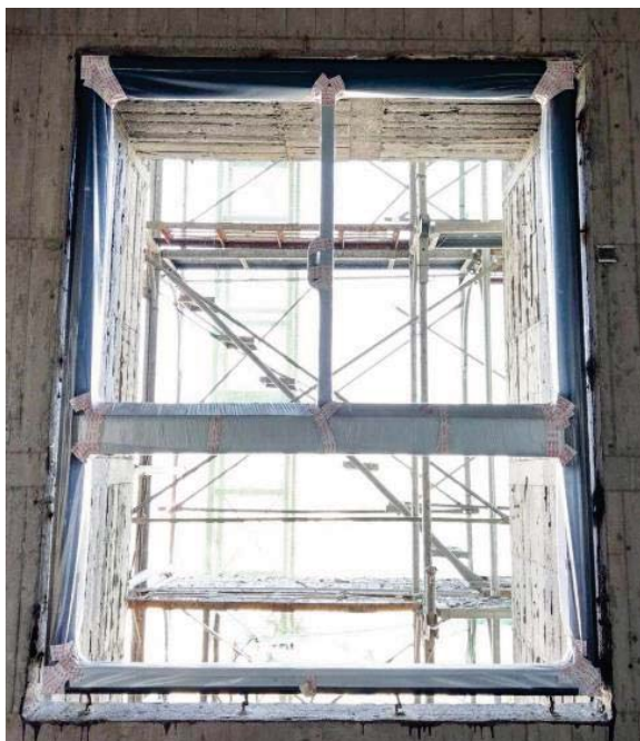
嵌縫品質不良易漏水
