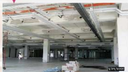
● 2F 機電- 空調架管
