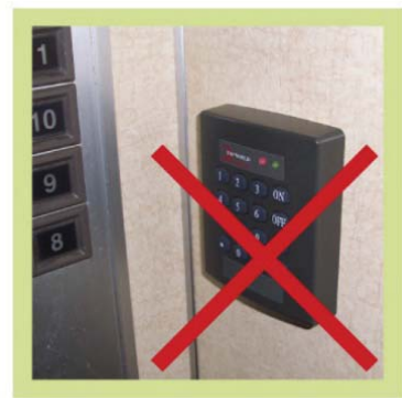
▶ 緊急用昇降設備不可設刷卡機
