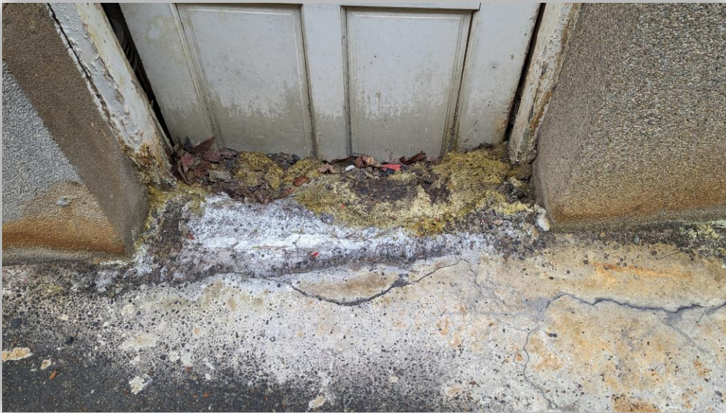
牆體變形及地坪因熱液換質導致門扇無法使用
