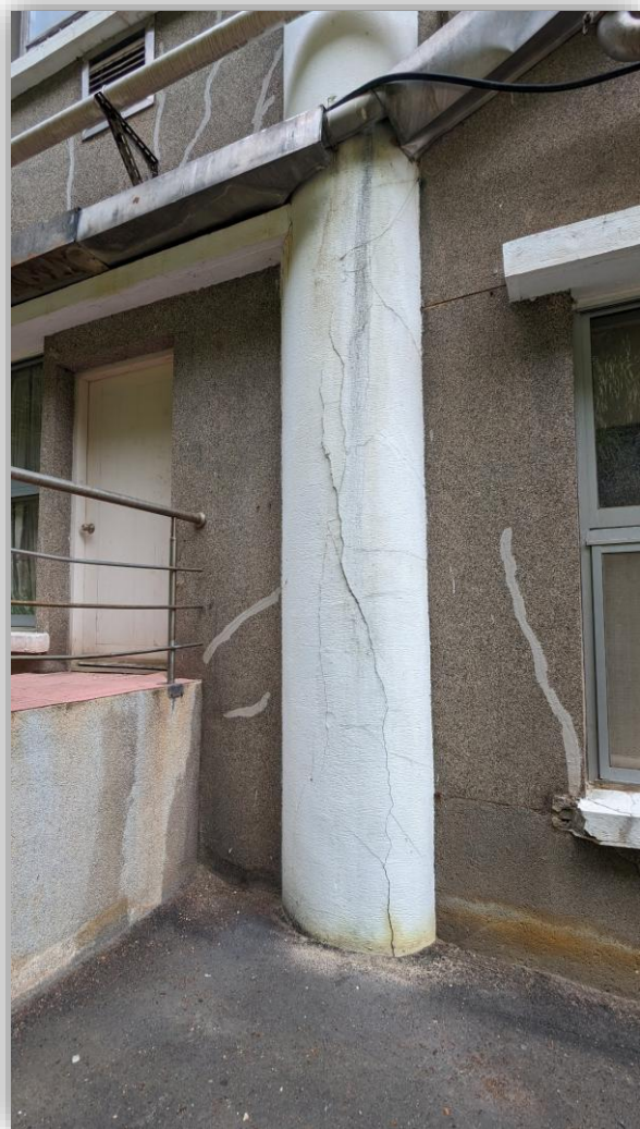
柱體垂直向裂縫
