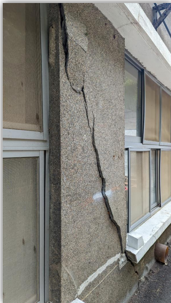
牆體斜向剪力裂縫
