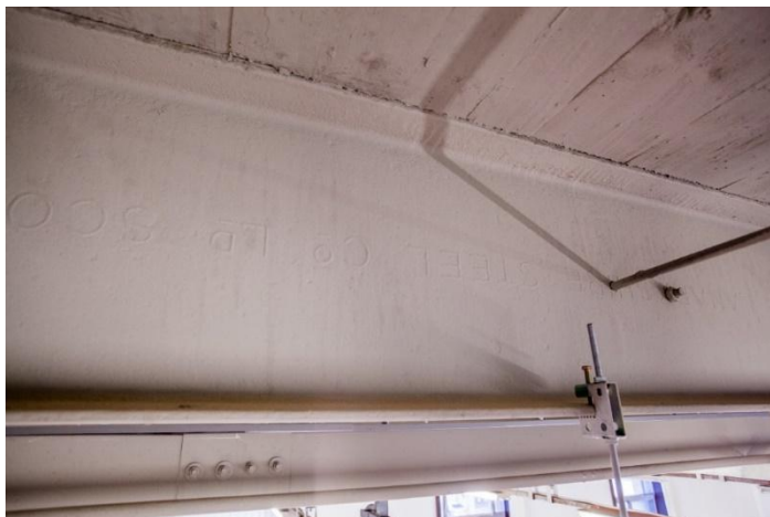
原始設計圖說與現況鋼樑構件比較
