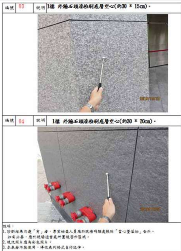
(B3)臺北市建築物外牆安全診斷現況照片-C例
