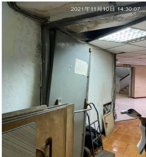
▲ 走廊通道堆積雜物
