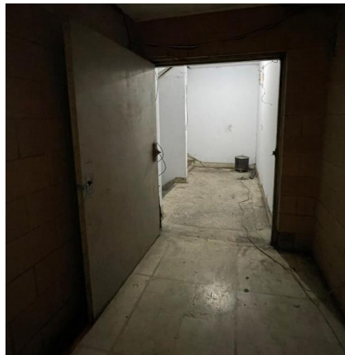
▲ 防火門無法正常復歸
