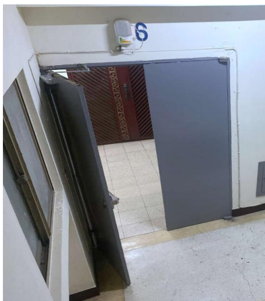
▲安全梯防火門無法自動復歸
