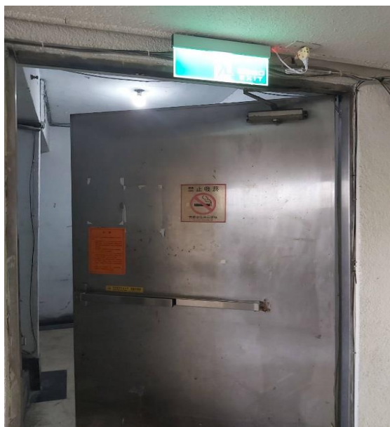
▲ 防火門無法正常復歸
