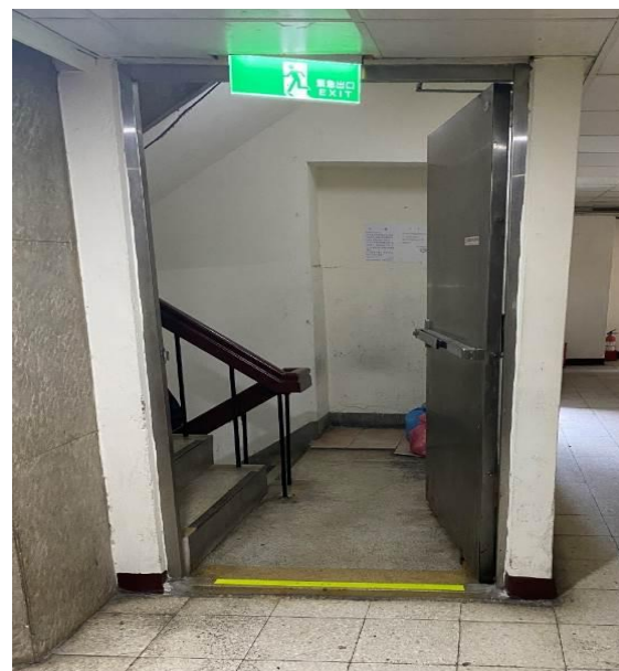
▲ 防火門無法正常復歸
