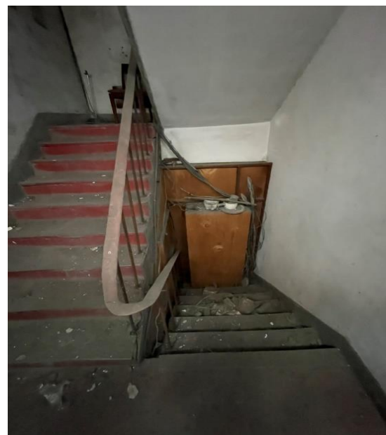
▲樓梯堆積雜物
