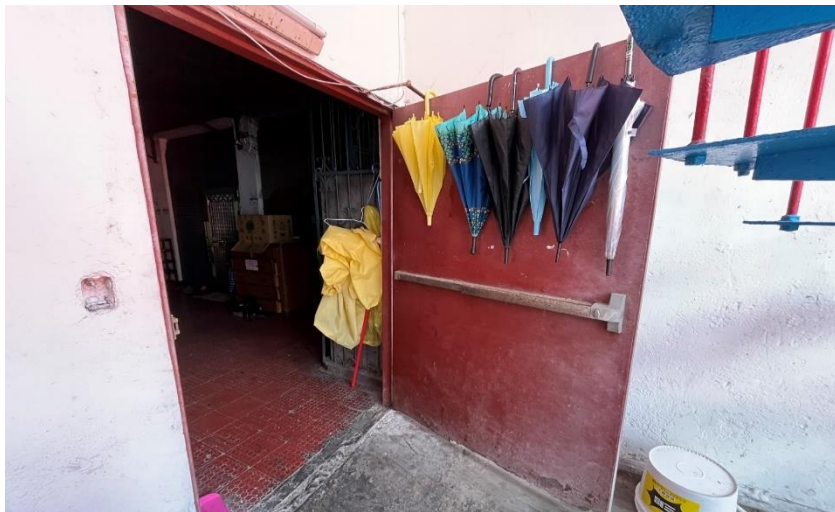
▲ 防火門無法正常復歸
