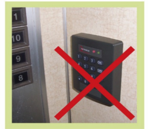
▶ 緊急用昇降設備 不可 設刷卡機
