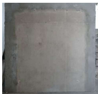
NewRC 版 (0.1%體積比聚丙烯纖維)
