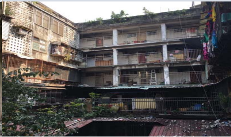
建物機能落後
