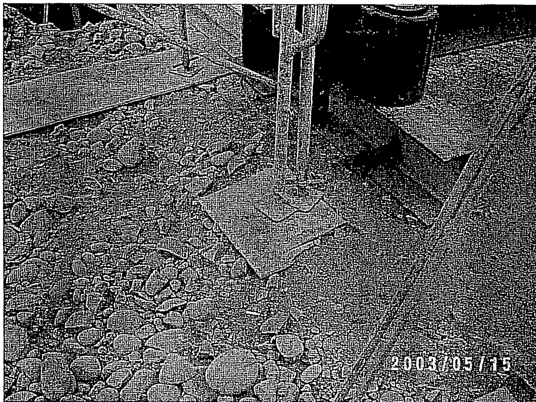
圖 14 施工現場架設不平整
